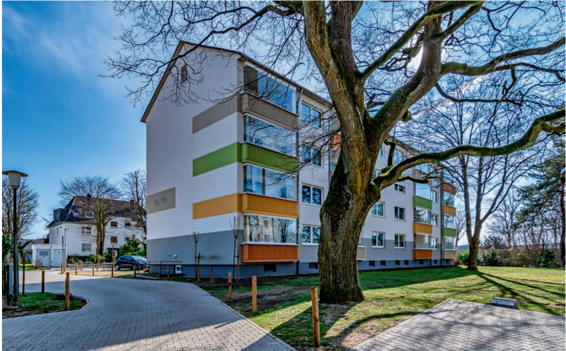
Südstraße 139-161, Waldecker Straße 16-18, Erneuerung der Straße und Erstellung von weiteren Stellplätzen – Foto: Gábor Wallrabenstein
